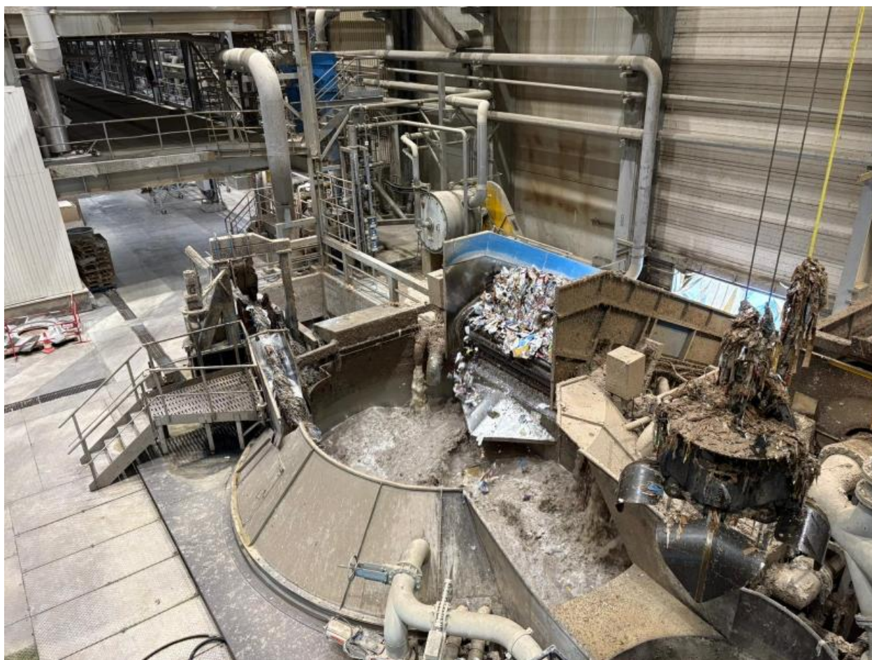
Blue Paper – Station de récupération et traitement des papiers et cartons usagés à recycler.
